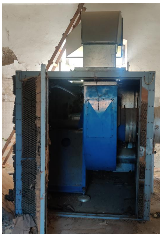
Foto 1 (Impianto di aspirazione con relativo gruppo motori)
