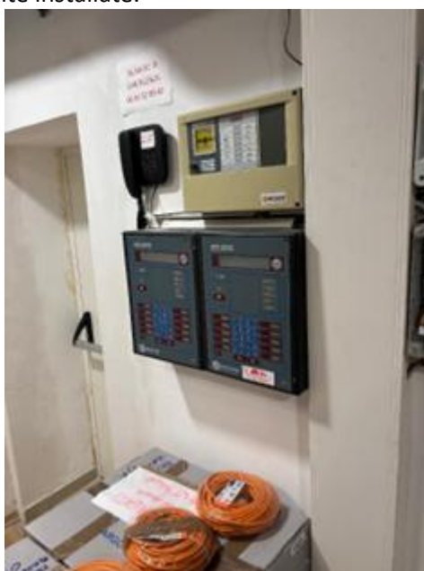
10. Centrali esistenti nella Centrale telefonica
