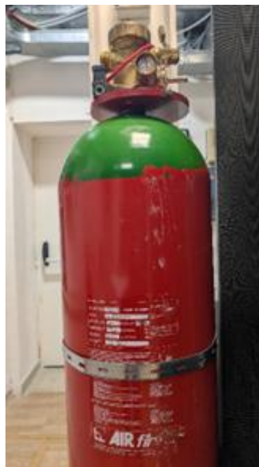
4. Una delle bombole attualmente presenti nella Centrale Telefonica
