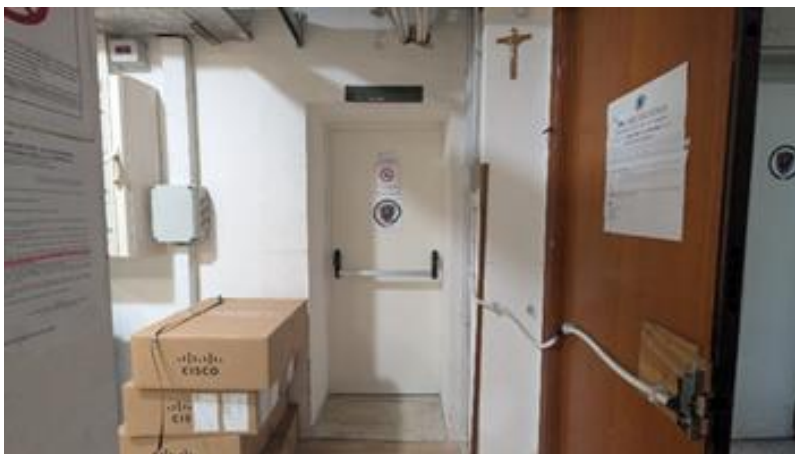
6. Porta resistente al fuoco attualmente presente nella Centrale telefonica
