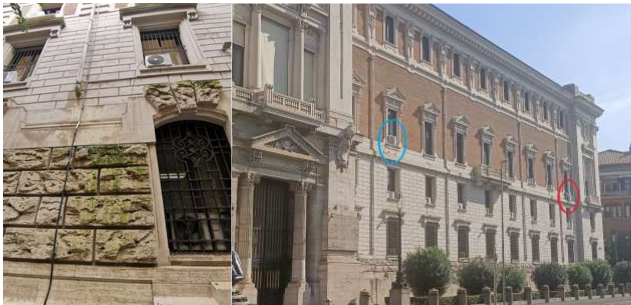
Condizionatori e ammaloramento delle facciate – via Filangeri / Lungotevere
