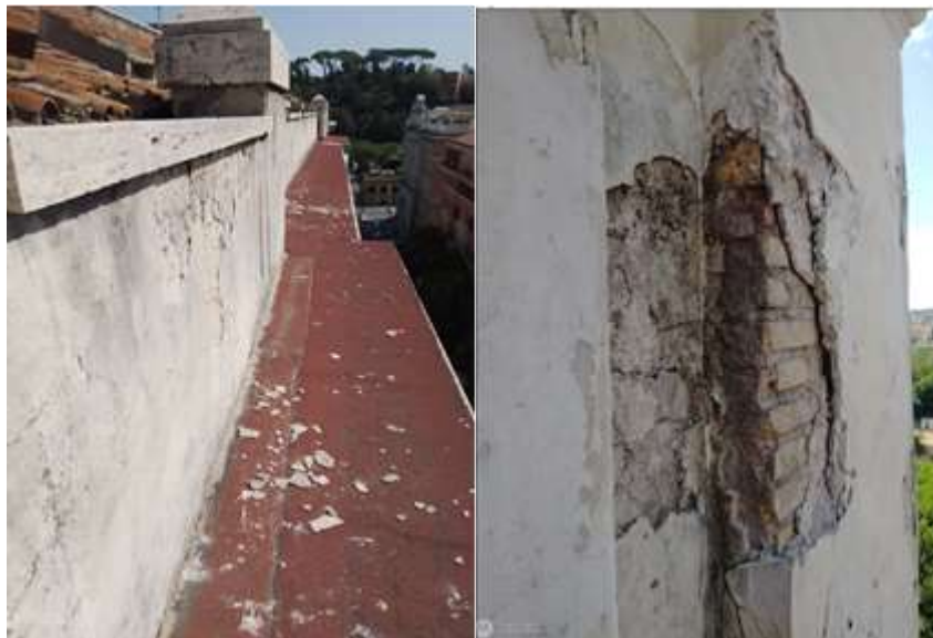
Casi di degrado delle porzioni sommitali
