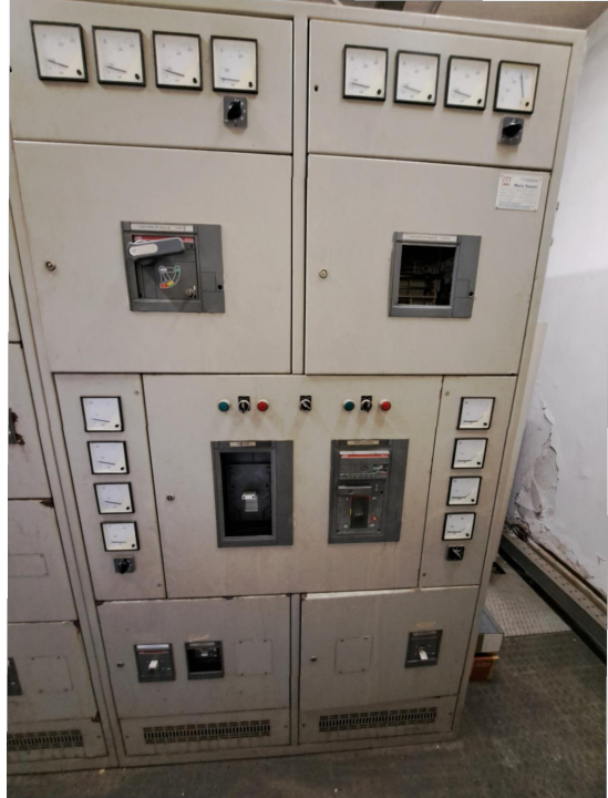
QE GBT ESISTENTE - MOTORIZZAZIONI INTERRUPTORI MANCANTI
