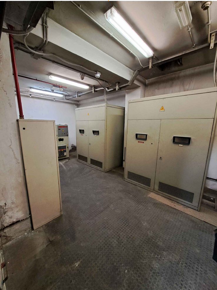
BOX TRAF0 400KVA
