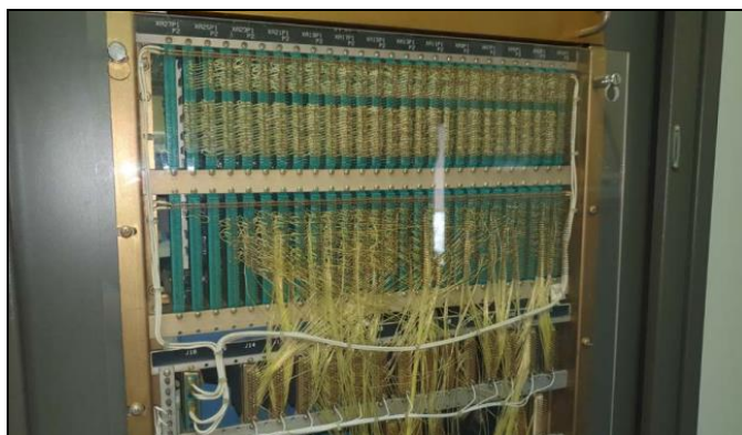
Figura 4 – Cabine di interfaccia (vista 2)
