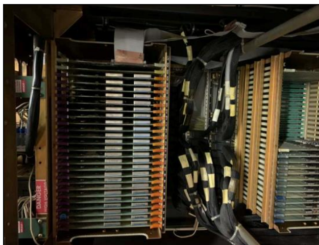
Figura 3 – Cabine di interfaccia (vista 1)
