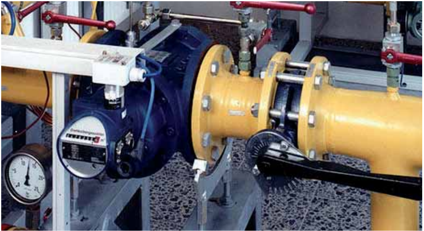
Sopra. Misuratori di gas.
