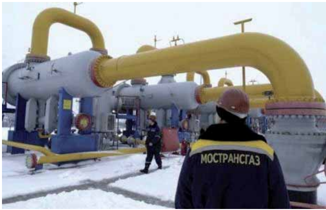
Impianti di un gasdotto.
