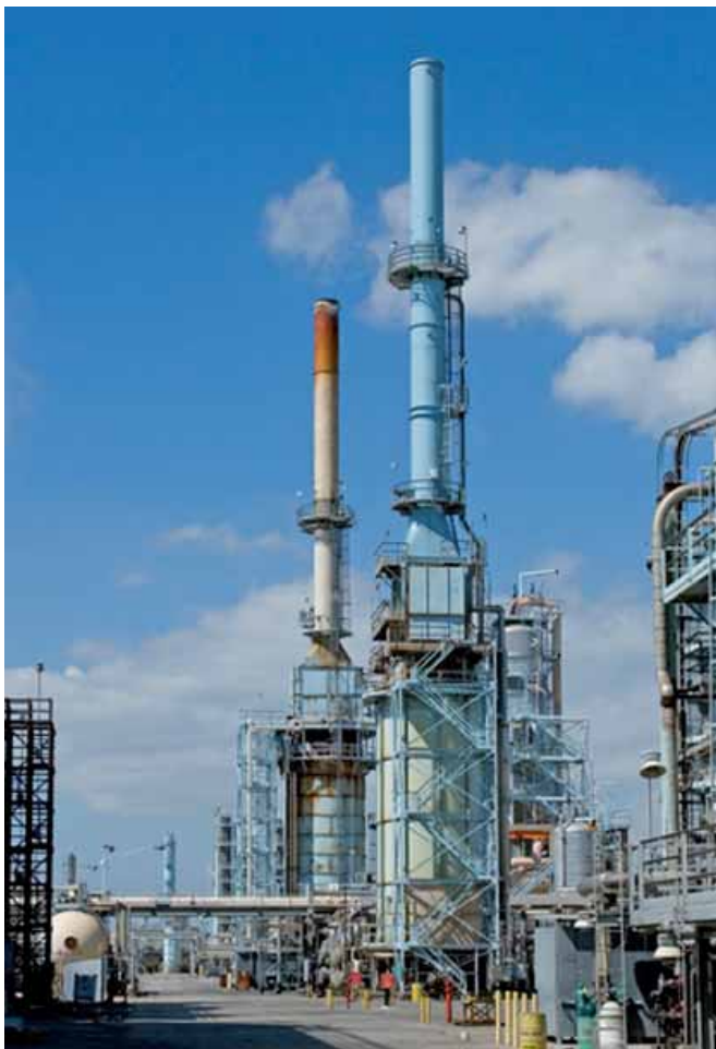
Impianti di un gasdotto.
