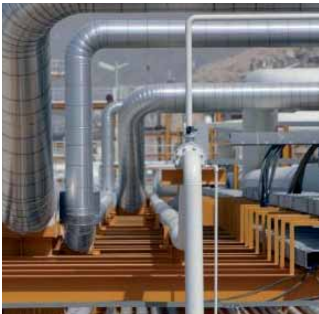
Un impianto per la raffinazione del gas.
