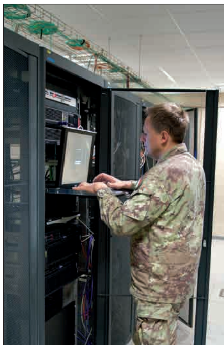
Personale in attività al Data Center della Nci Agency (foto Nicola Palermo, N.C.I.A.)
